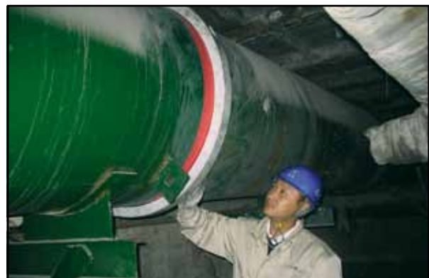
40" Rings an einer Förderleitung in China (Stahlindustrie)
